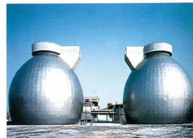
北九州市壱后橋下水処理場 4,000m 3 2基
