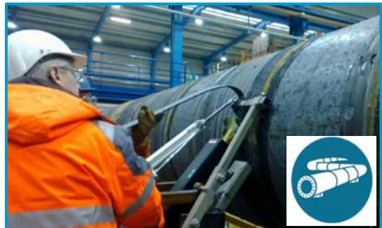
パイプライン：アスベスト含有コーティング
